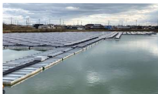
太陽電池フロート
